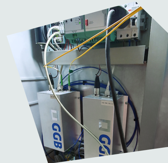
Die Messanlage in Aktion
